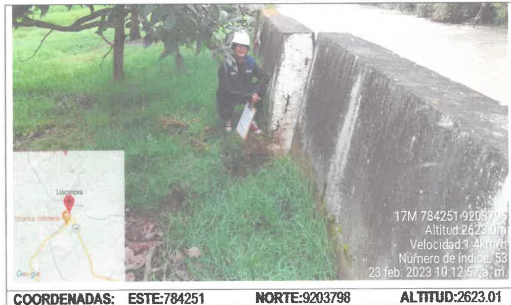
Figura 13: Muro de concreto a punto de colapsar por socavación producto de las máximas avenidas.
