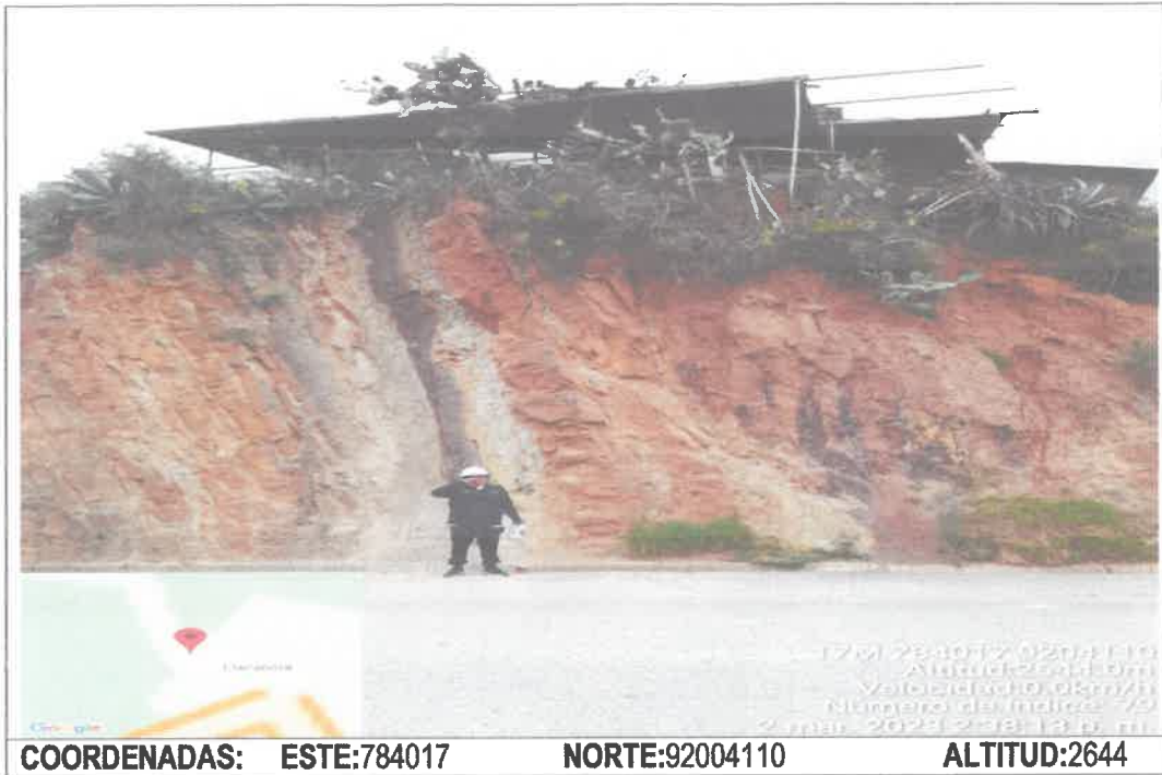
Figura 17: Posible vivienda afectada por derrumbe al estar borde del talud de la carretera.
